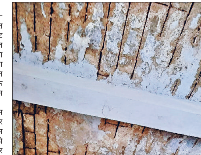
भिवानी। सरकारी स्कूल के एक कमरे की छत में निकले लौहे के जर्जर सरिरे।
